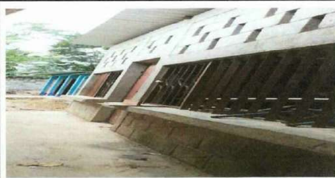
Foto 4: EN ESTA FOTOGRAFIA SE OBSERVA EL DETERIODO DE MUROS INTERIOR Y EXTERIOR.
