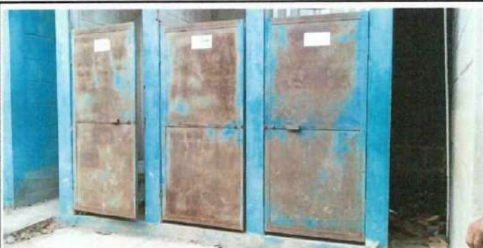
Foto 3: EN ESTA FOTOGRAFIA SE OBSERVA EL DETERIODO DE LAS PUERTAS, LA CUAL SE NECESITA EL MANTENIMIENTO Y CAMBIOS.
